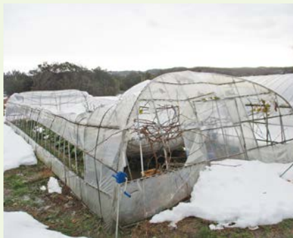
雪の重みで倒壊したハウス
