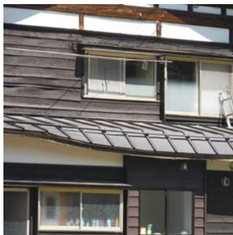
積雪の重みで、軒先の垂木が折れた住宅
