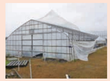
強風により被覆物に被害を受けたハウス
