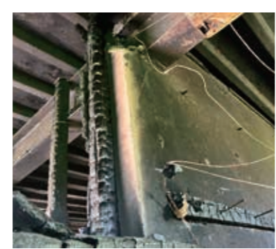
電気配線のショートにより、火災になった農作業場
